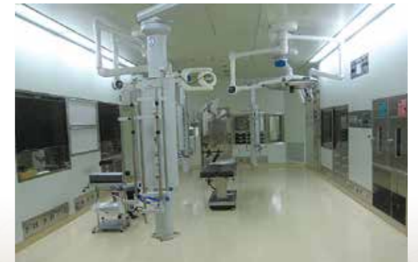
新しくなった中央手術部(手術室) Central Operating Division
